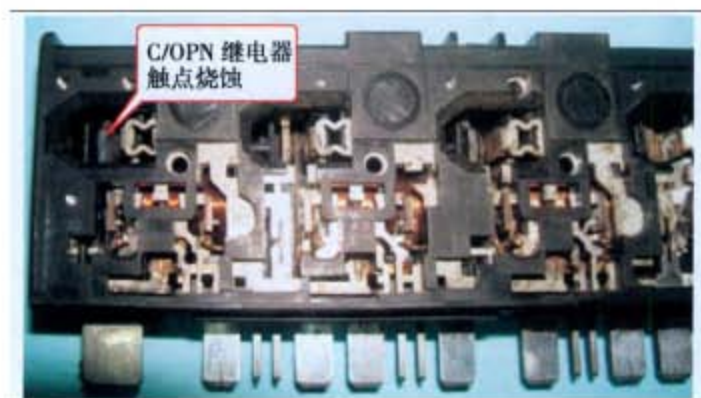
图 1 故障车 EIF 集成继电器内部情况
