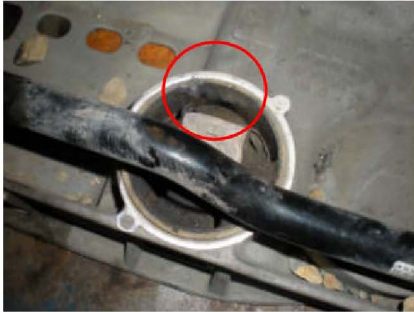
图 3 石子已将橡胶支座损伤
